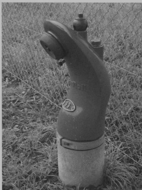
Hydrant 2003 beim Tanklager Balmhof.
